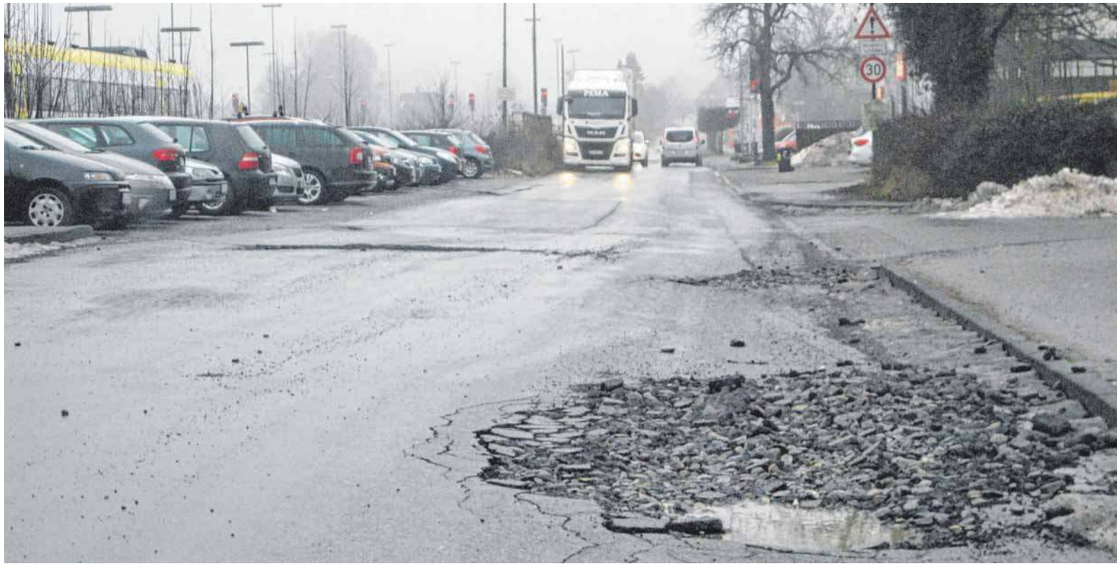
Die vielen vom Frost aufgebrochenen Stellen in der Poststraße hat die Stadt mittlerweile mit Schotter aufgefüllt.
